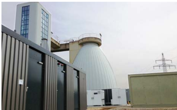
Die Verbandskläranlage Schwandorf-Wackersdorf Foto: MicrobEnergy GmbH
