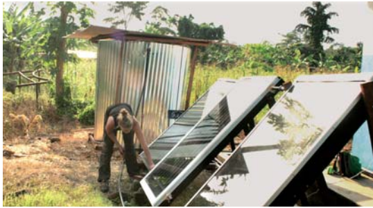
Aufbau der Solarthermieanlage zur Warmwasser-Bereitung an der Klinik
