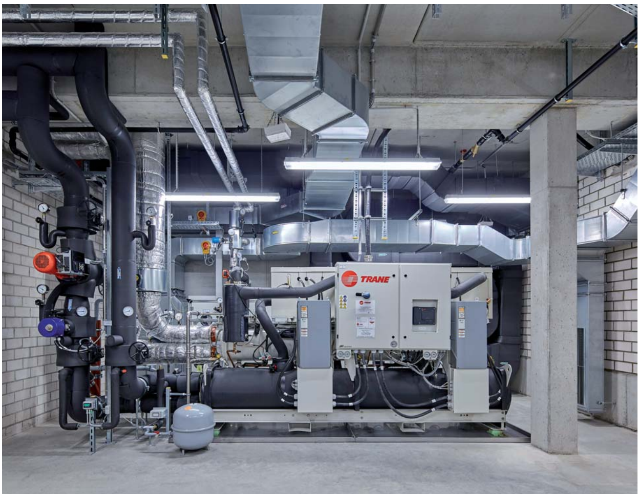
Die neue Kälteanlage der OTH Regensburg ist seit Mitte 2018 in Betrieb. Foto: OTH Regensburg / Florian Hammerich
